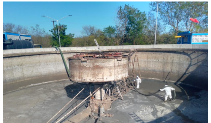
MANTENIMIENTO DE PLANTAS TRATADORAS
